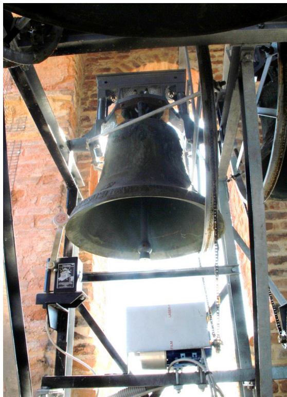
Fig. 7 – Particolare dell'elettrificazione: motore e percussore
